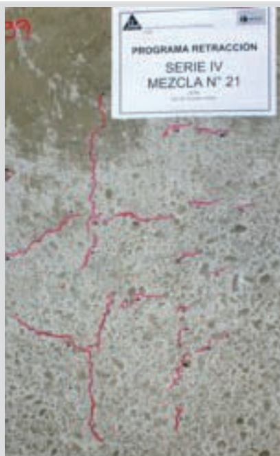
Fig. 2 - Concreto 4000 psi a las 24 hrs, expuesto a viento de 2 m/s
